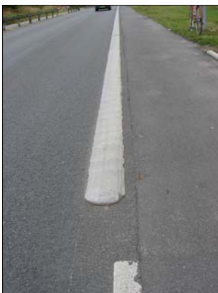
Un bourrelet en béton est en cause à Montlouis.
